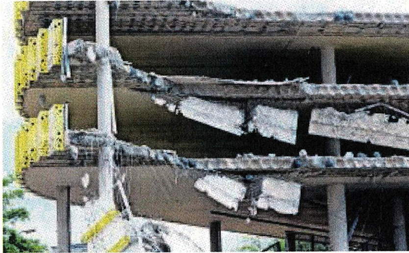
▲ Het ingestorte deel van de garage, waarvan de bouw eerder had moeten worden stilgelegd. FOTO FOTOPERSBUREAU BERT JANSSEN
