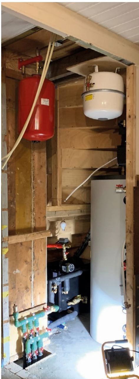
Warmteboiler in een trapkast geplaatst.
