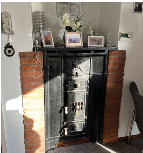
Moederkachel van verwarmingsinstallatie in de Deense woning.
