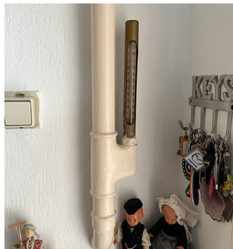
C.V. leiding met thermostaat in Deense woning.
