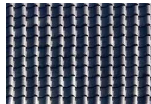
donkere, gesmoorde dakpan
