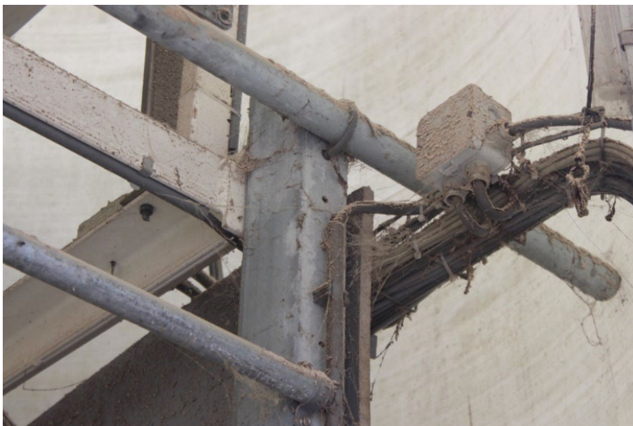
Figuur 2.32 Stof in een voederinstallatie (Bron: Brandweeracademie)
