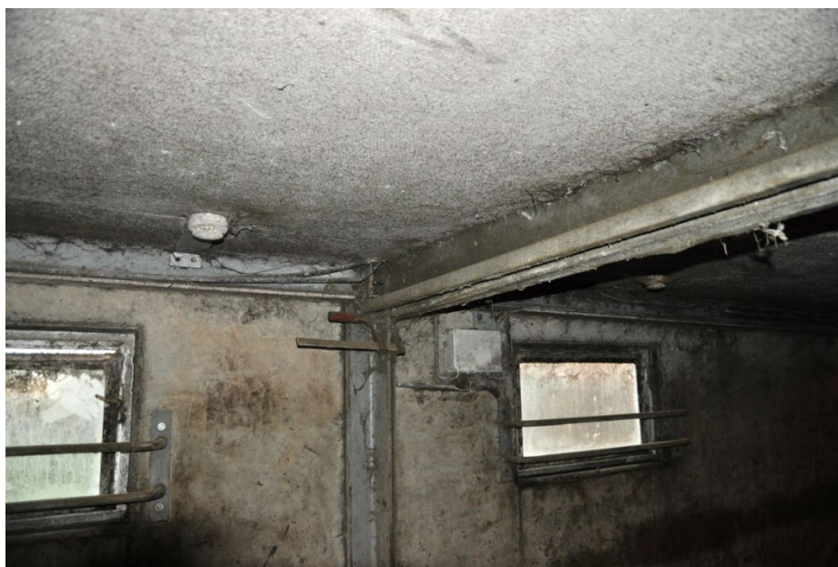
Figuur 2.34 Brandwerend rolluik aangestuurd door rookmelder, rookmelder buitenwerking gesteld en rolluik vastgezet door veehouder (Bron: Team brandonderzoek brandweer Gelderland-Midden)
