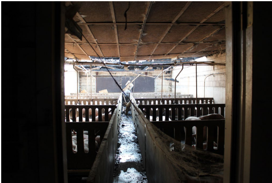
Figuur 2.33 Ravage in een varkensstal, waar brand heeft gewoed (Bron: Brandweeracademie)
