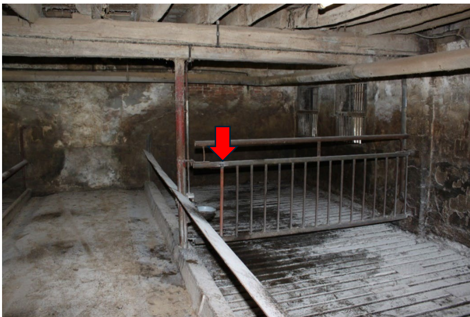
Figuur 4.1 Door het lassen van een losse metalen stang (zie rode pijl) van de kalverbox, ontstond er brand in deze mestkelder (Bron: Brandweeracademie)
