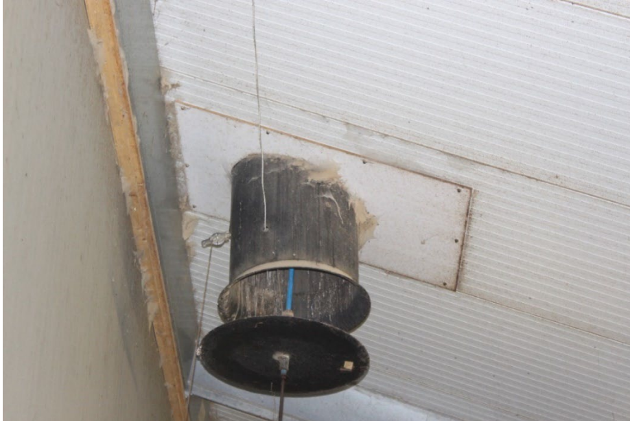
Figuur 2.18 Ventilatieschacht in het dak (Bron: Brandweeracademie)
