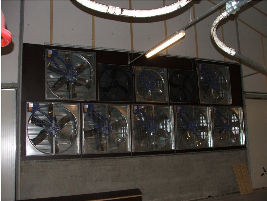
Figuur 2.16 Ventilatoren in de achterwand (Bron: Brandweeracademie)
