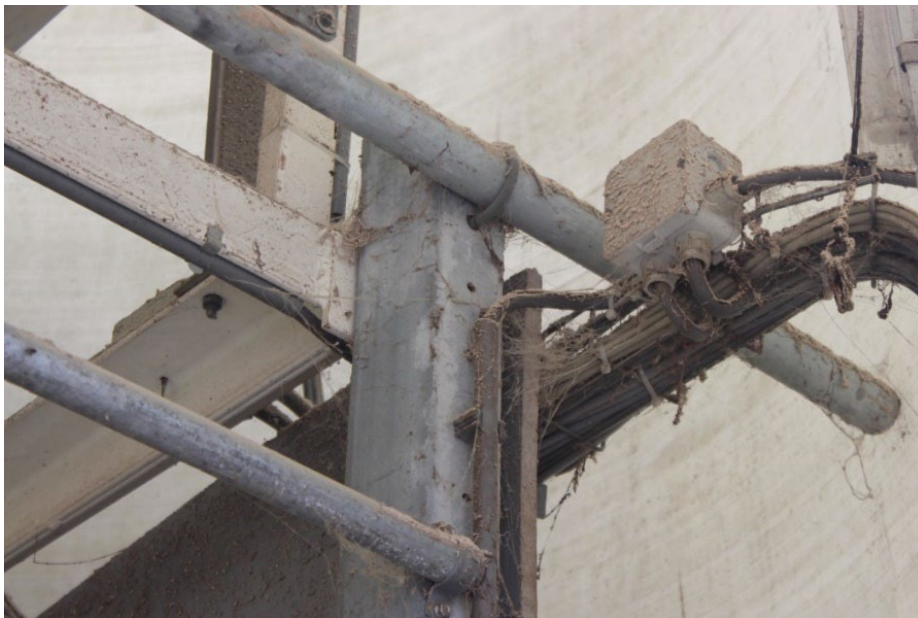
Figuur 2.32 Stof in een voederinstallatie (Bron: Brandweeracademie)
