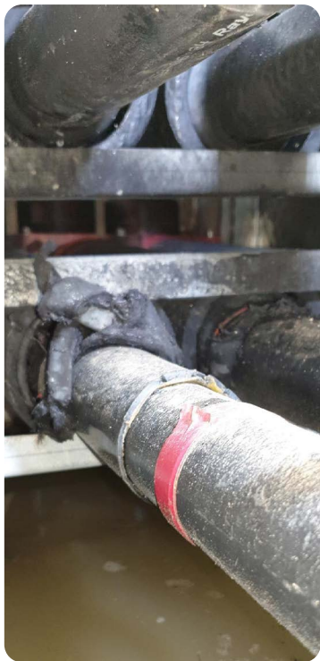
Figuur 13: Water in het keldercompartiment (bron: Enxsis).
