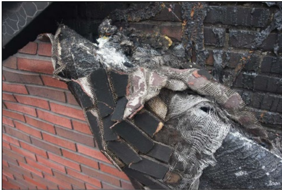
Figuur 4.1 Door brand uitgezakte isolatie met steenstrips en daaronder de originele buitengevel (foto: Goos Janssen)
